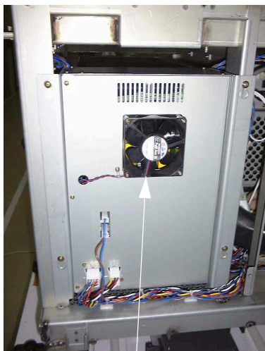
Fan for HV unit
